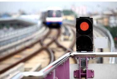
應用範例：軌道沿線網路設備
